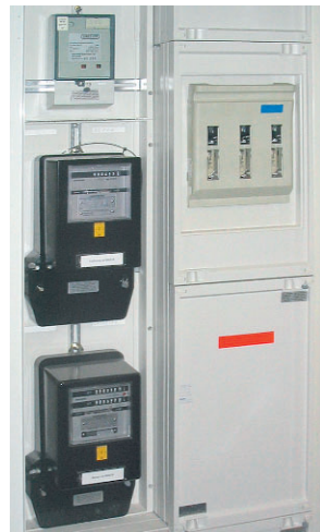
BHKW-Modul und Zählerkonfiguration
